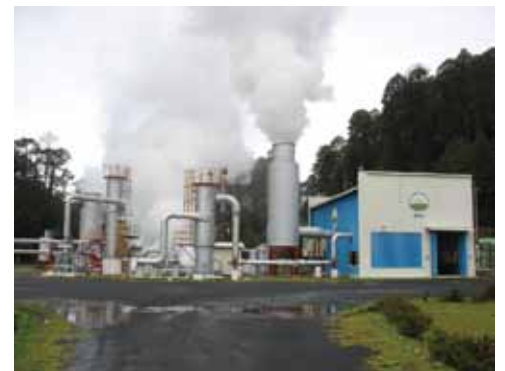
Energía eléctrica generada por el Campo Geotérmico Los Azufres, reconocido como un supervolcán.
